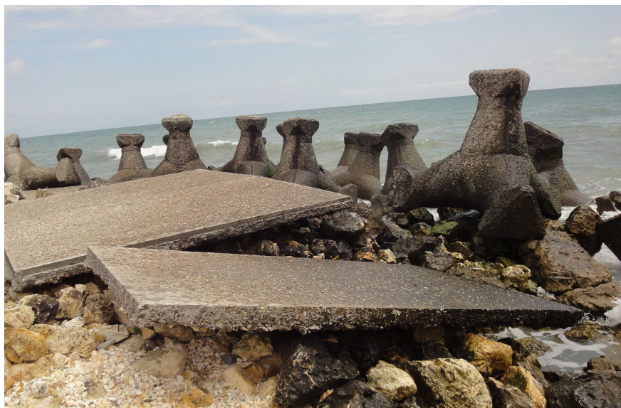
Figura 2.8.2 Dig grav deteriorat
